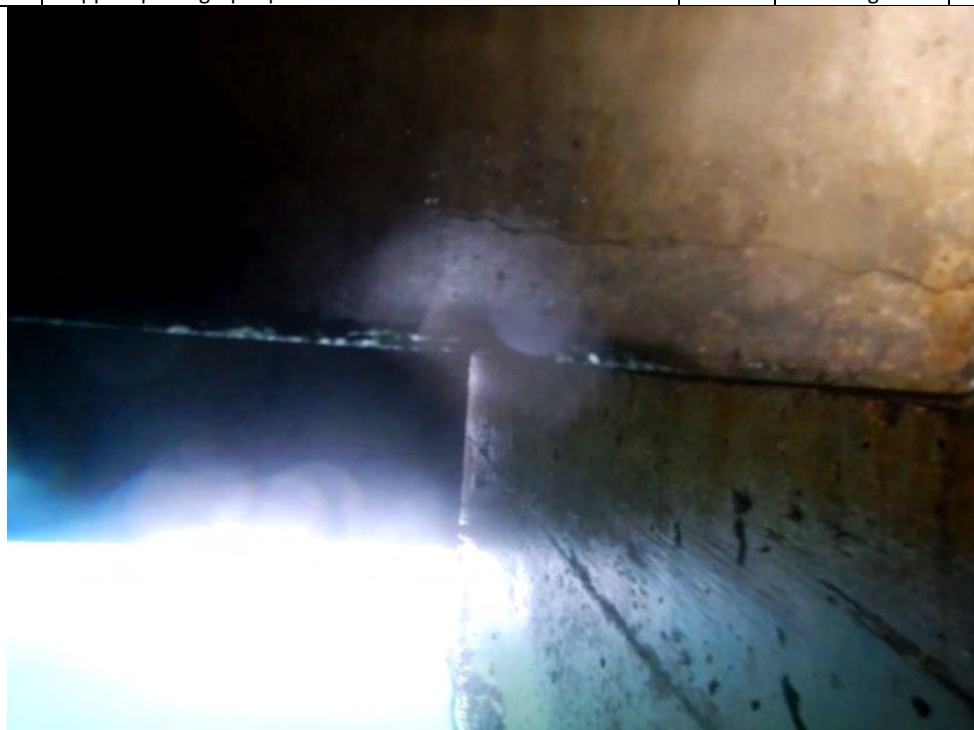
Face latérale ouest de la poutre P-6 no.2-coté ouest de la cale de halage – fissure horizontale près de l'appui sud
