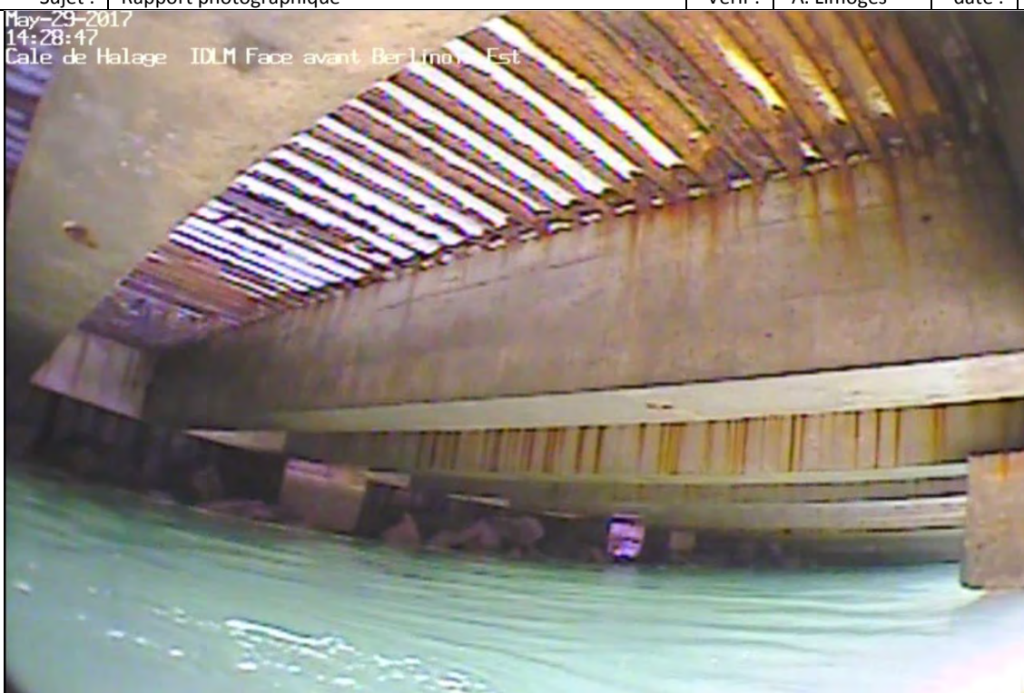
Vue générale des poutres P-1 no. 8 et no. 7 coté est de la cale de halage – condition typique
