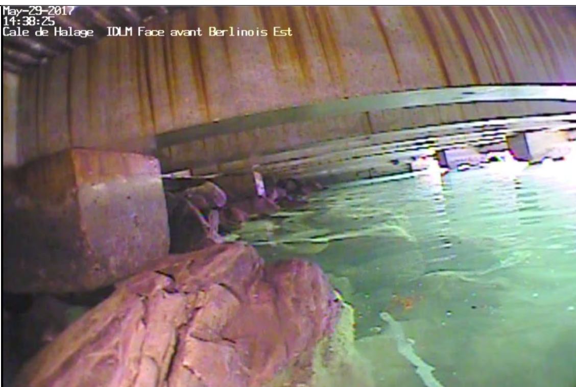
Tête de pieux T-3 no.3 côté est de la cale de halage (colonne D4) et face nord de la poutre P-2 no.3-côté est
