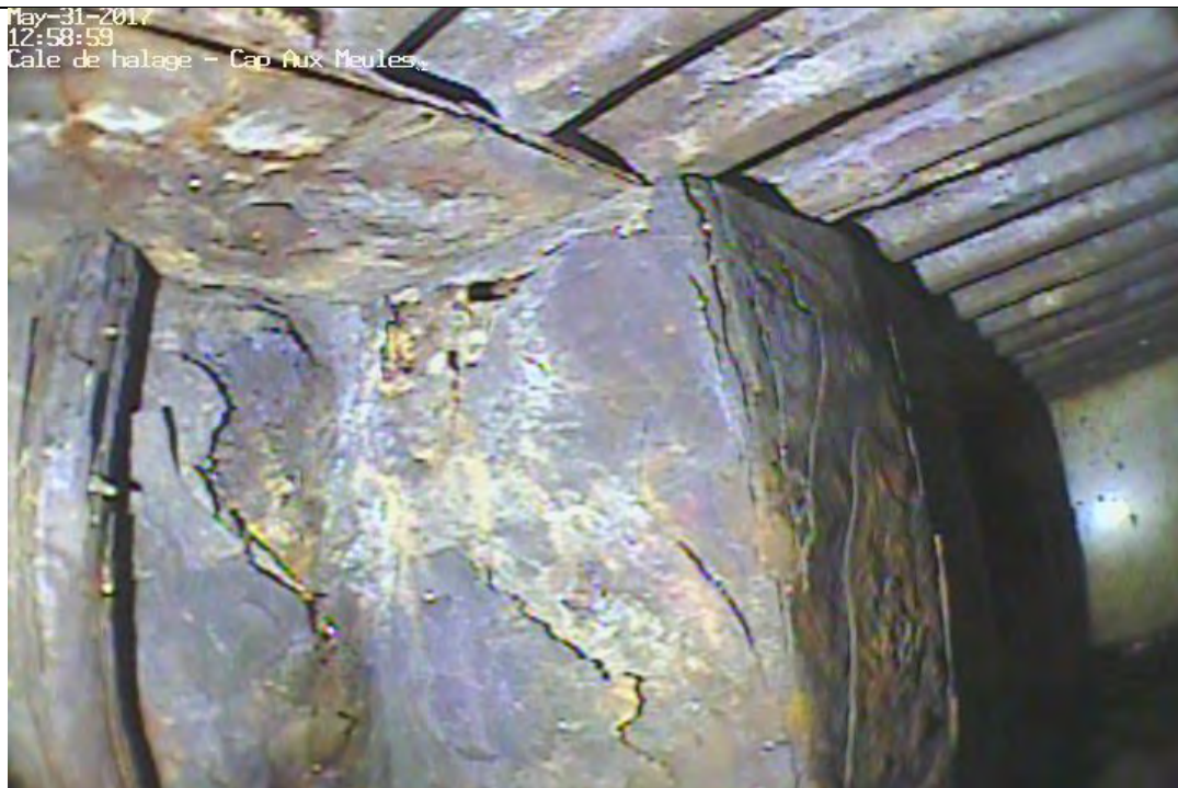
Mur de palplanches nord, jonction entre le dessous du tablier et le dessus de la palplanche côté est de la cale de halage- perforation
