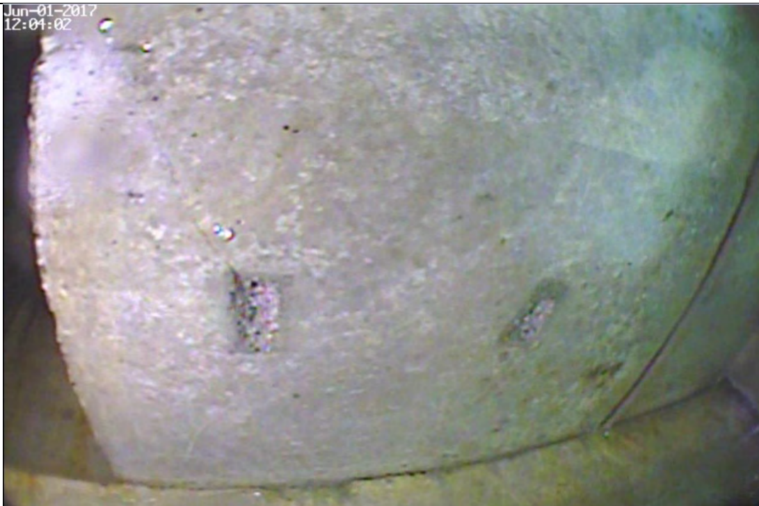
Face inférieure de la poutre P-6 no.1-coté ouest de la cale de halage – éclatement mineur et fissure longitudinale
