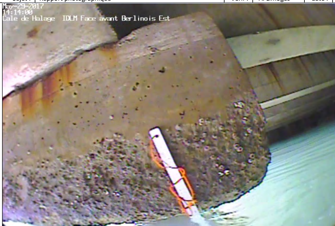
Tête de pieux T-4 no.2 côté est de la cale de halage (colonne C3) – érosion légère
