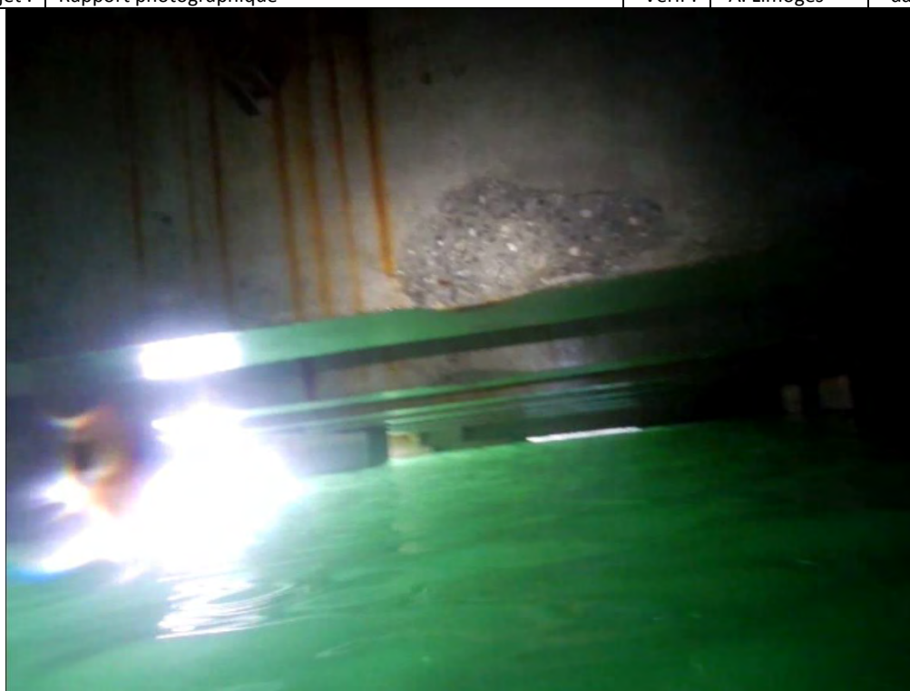
Face latérale nord de la poutre P-1 no. 5 côté ouest de la cale de halage – éclatement 500 x 400 mi-portée
