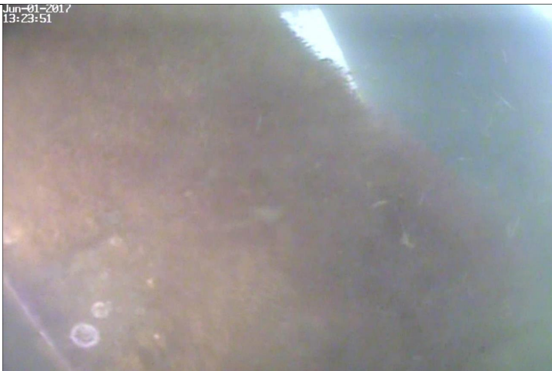
Aile du pieu de la colonne B2 – Condition de la surface d’acier
