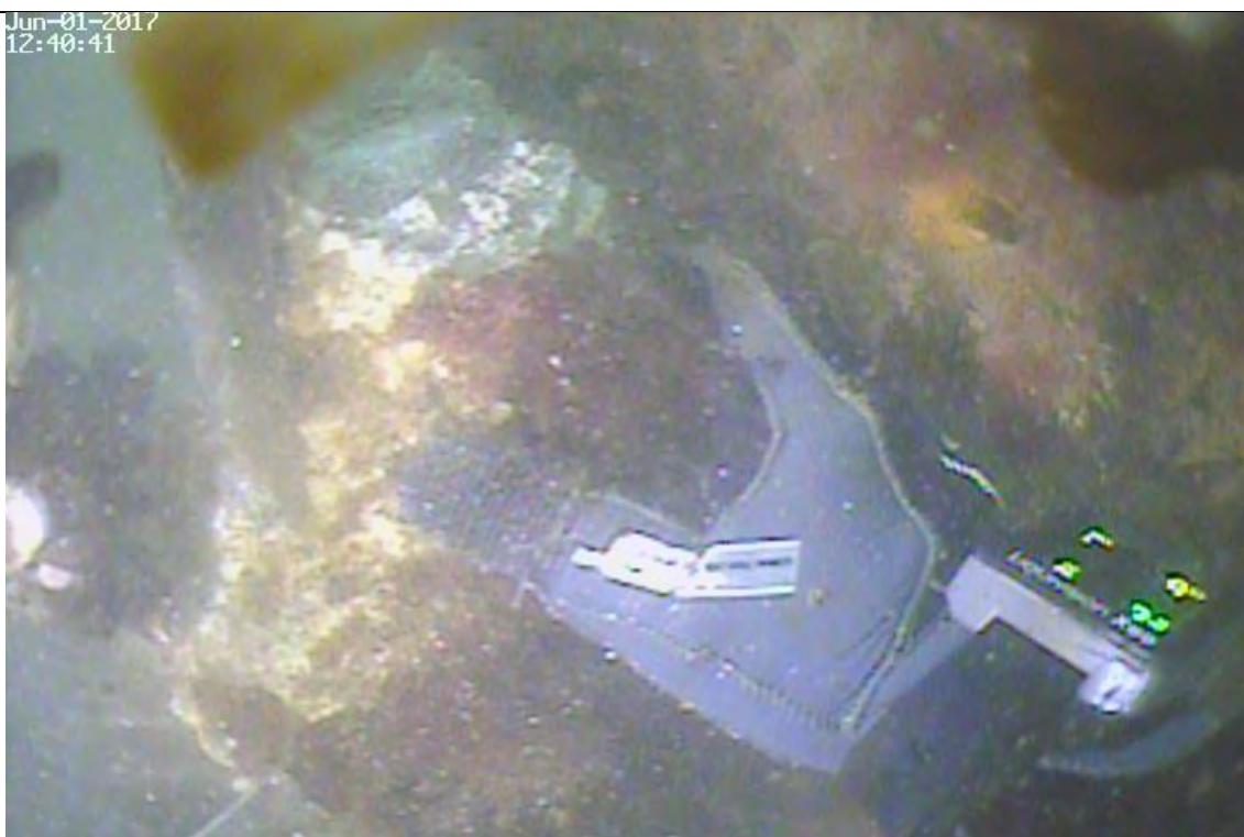
Anode sacrificielle – Pieu de la colonne A1, mur berlinois
