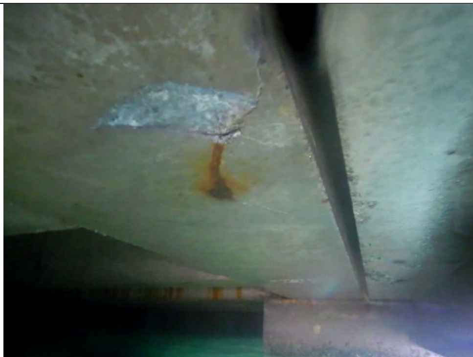
Face inférieure de la poutre P-6 no.3-coté ouest de la cale de halage – zone d'éclatement 150 x 150, délamination et corrosion au droit de la jonction avec la poutre P-1 no.5 côté ouest de la cale de halage
