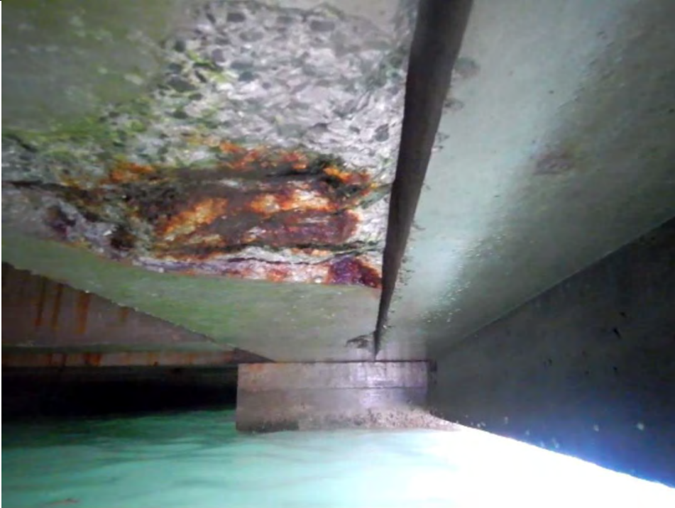
Face inférieure de la poutre P-6 no.1-côté ouest de la cale de halage – zone d'éclatement 600 x 400 avec armature apparente et corrosion au droit de la jonction avec la poutre P-1 no.1 côté ouest de la cale de halage
