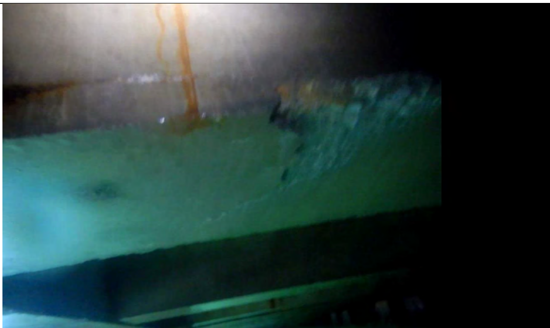
Face inférieure de la poutre P-1 no. 8 côté ouest de la cale de halage – éclatement et délamination près de l'appui es
