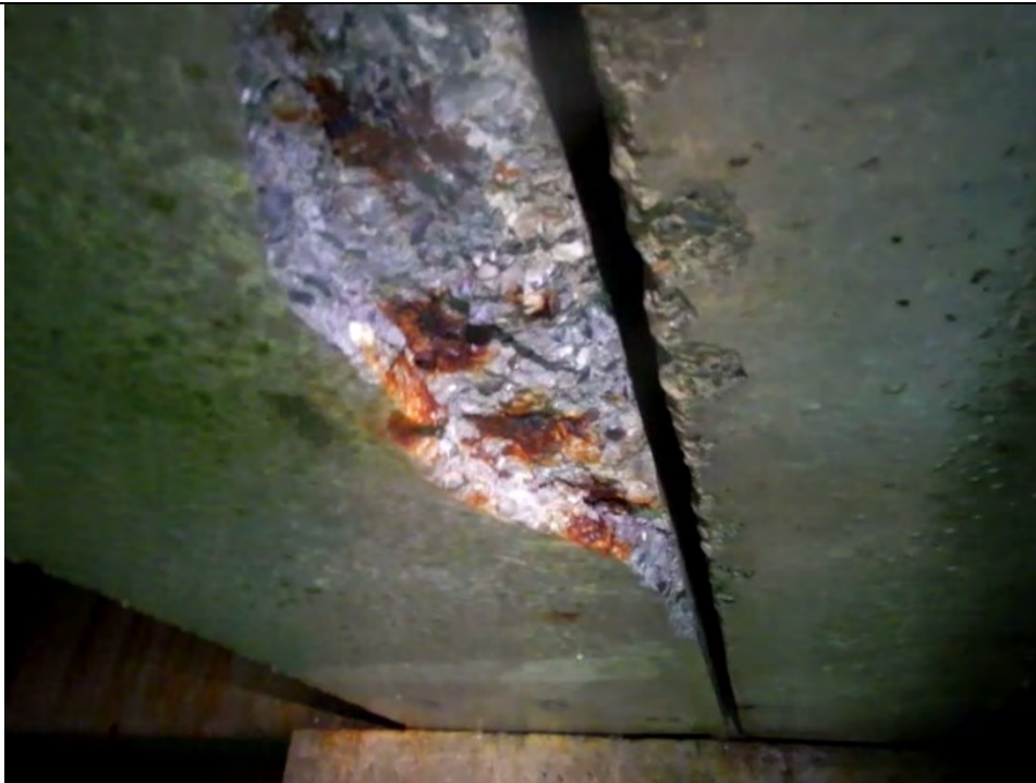
Face inférieure de la poutre P-6 no.1-côté ouest de la cale de halage – zone d'éclatement 600 x 200 avec armature apparente et corrosion au droit de la jonction avec la poutre P-1 no.2 côté ouest de la cale de halage
