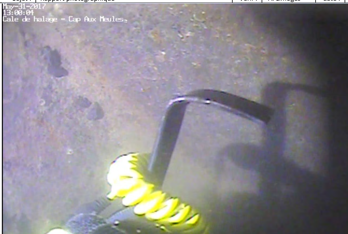
État de la surface du mur de palplanches à l'élévation approximative +0,6 m
