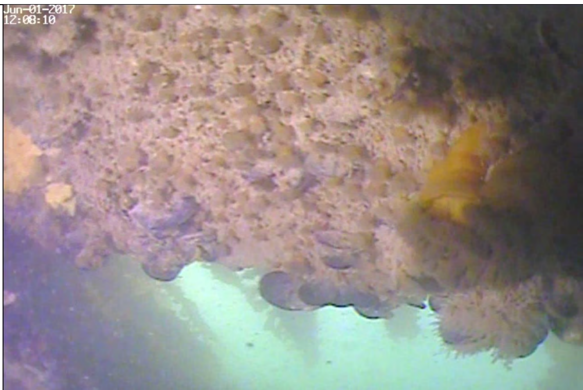
Mur berlinois frontal ouest, face nord – Panneau de béton manquant entre colonne A1.6 et A2
