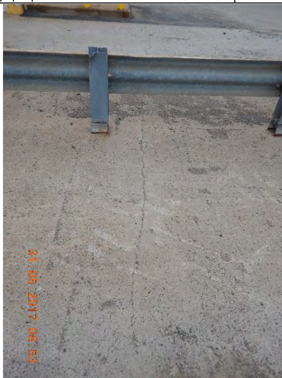
Fissure dans la dalle du tablier du côté ouest de la cale de halage au-dessus d'une poutre transversale
