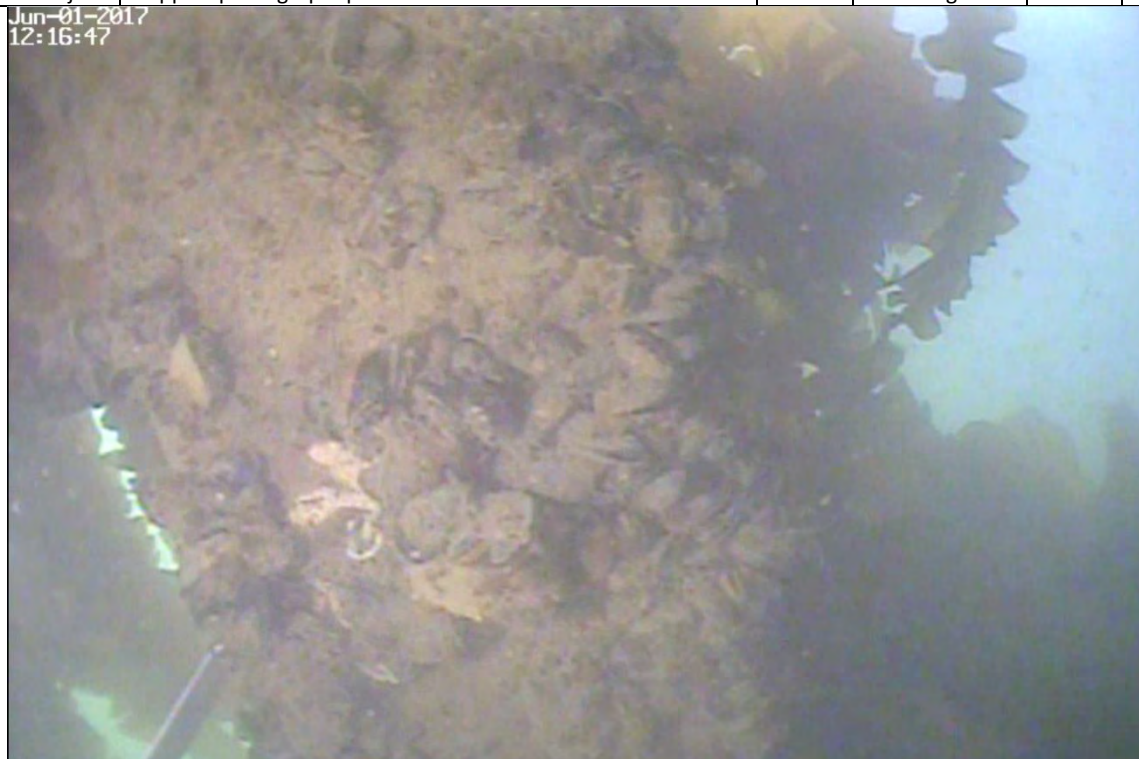
Mur berlinois frontal ouest, face nord – Colonne A1.6, panneaux de béton manquants de part et d'autre
