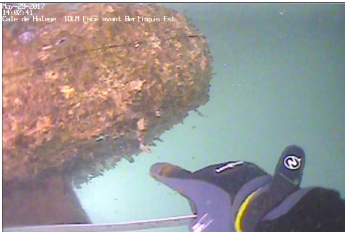
Dessous de la tête de pieu T-4 no. 1 côté est – érosion légère
