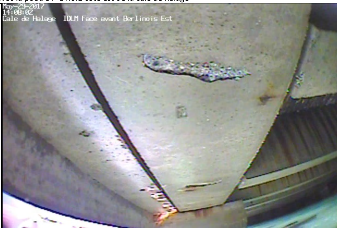
Face inférieure de la poutre P-6 no.2-coté est coté est de la cale de halage – éclatements mineurs visibles au droit de la jonction avec les poutres P-1 no.3 et 4 coté est de la cale de halage
