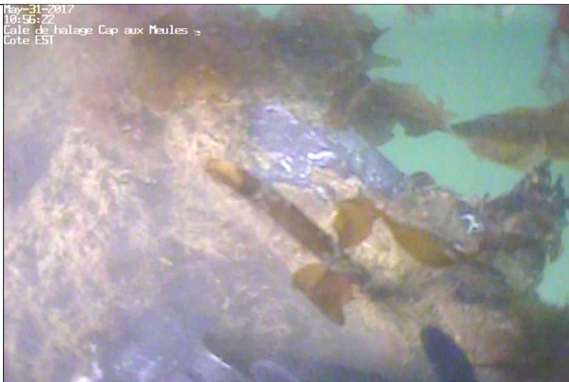
Aile du pieu de la colonne C3 – Condition de la surface d'acier
