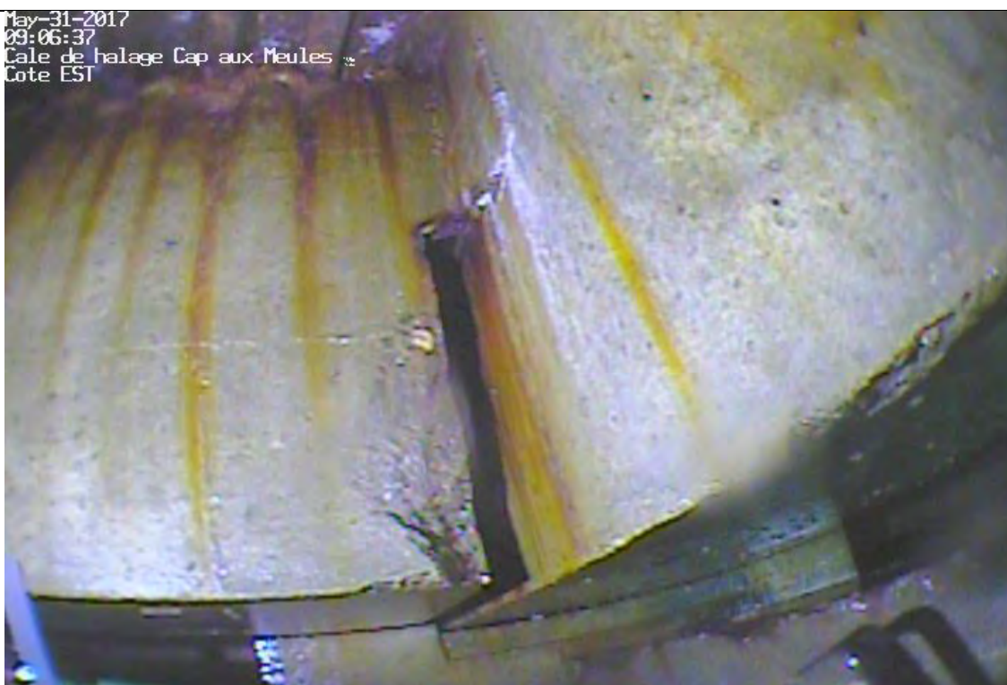
Face latérale nord de la poutre P-1 no. 1 coté est de la cale de halage – éclatement au droit de l'appui est
