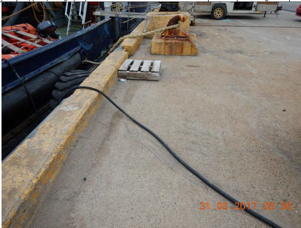
Vue générale de la surface du tablier côté ouest de la cale de halage – vue vers l'ouest
