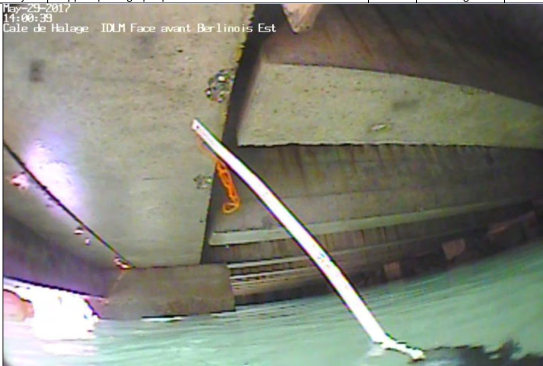
Face inférieure de la poutre P-6 no.1-coté est de la cale de halage – éclatement mineur visible au droit de la jonction avec la poutre P-1 no.1 coté est de la cale de halage
