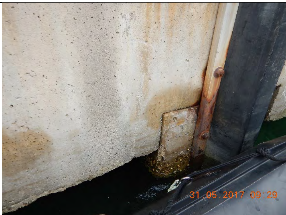
Appui sud poutre P-5 no. 3 côté est de la cale de halage – érosion \pm 120 mm (H) du bas de la poutre
