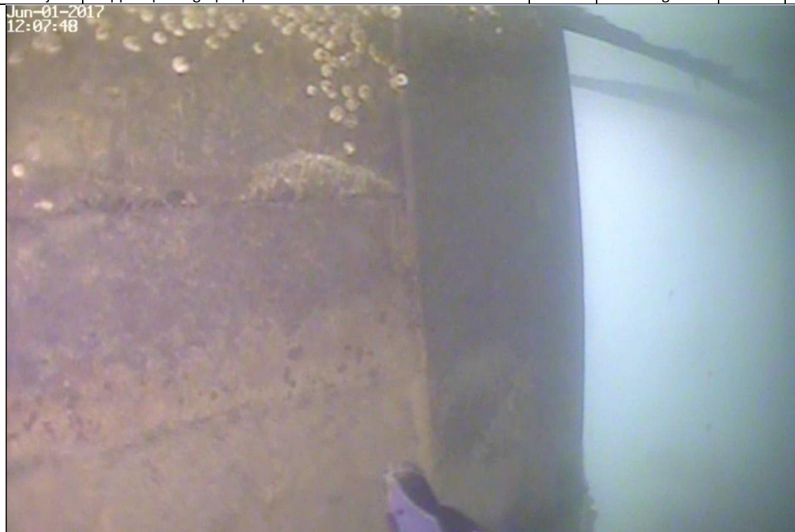
Mur berlinois frontal ouest, face nord – Panneau de béton manquant entre colonne A1.3 et A1.6
