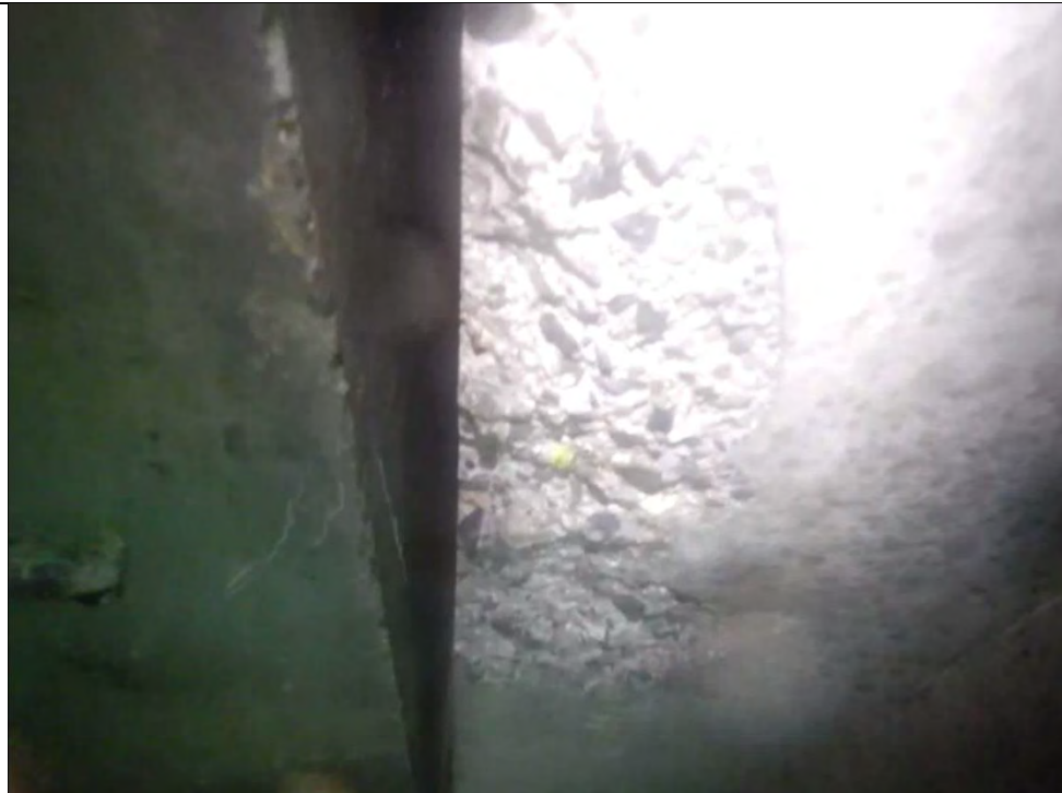
Face inférieure de la poutre P-5 no.3-côté ouest de la cale de halage – zone d'érosion 400 x 150 au droit de la jonction avec la poutre P-1 no.6 côté ouest de la cale de halage
