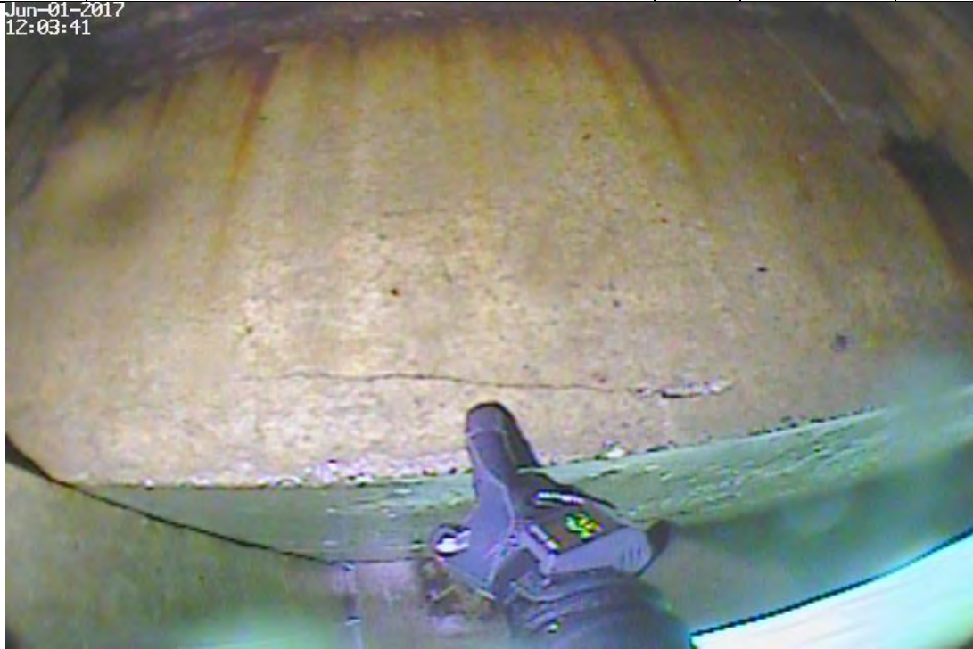
Face latérale ouest de la poutre P-6 no.1-coté ouest de la cale de halage – fissure horizontale visible près de l'appui nord
