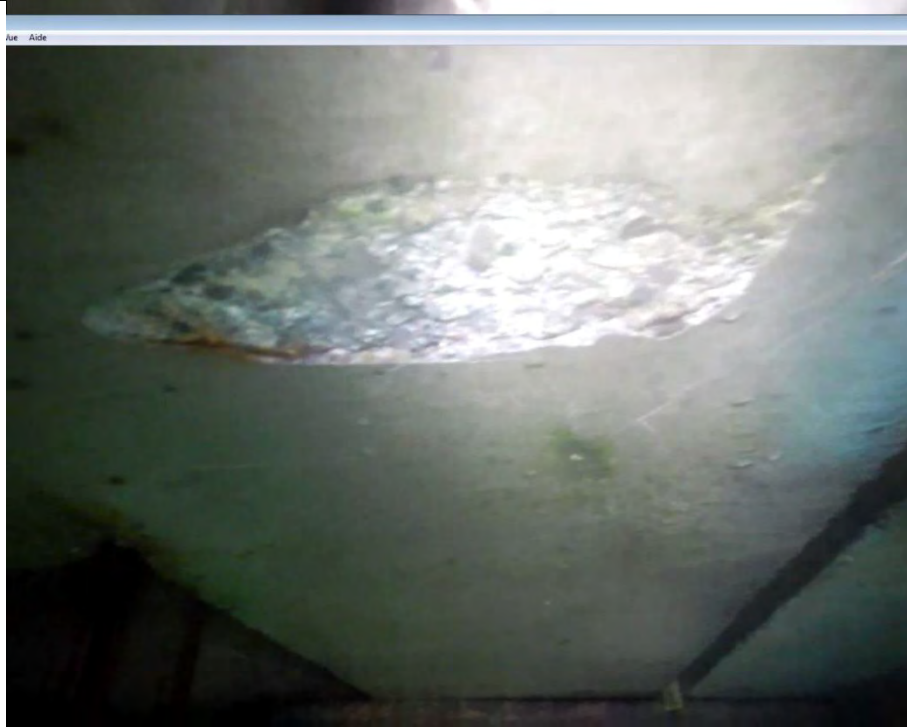
Face inférieure de la poutre P-6 no.3-côté ouest de la cale de halage – éclatement 300 x 150 au droit de la jonction avec la poutre P-1 no.6 côté ouest de la cale de halage
