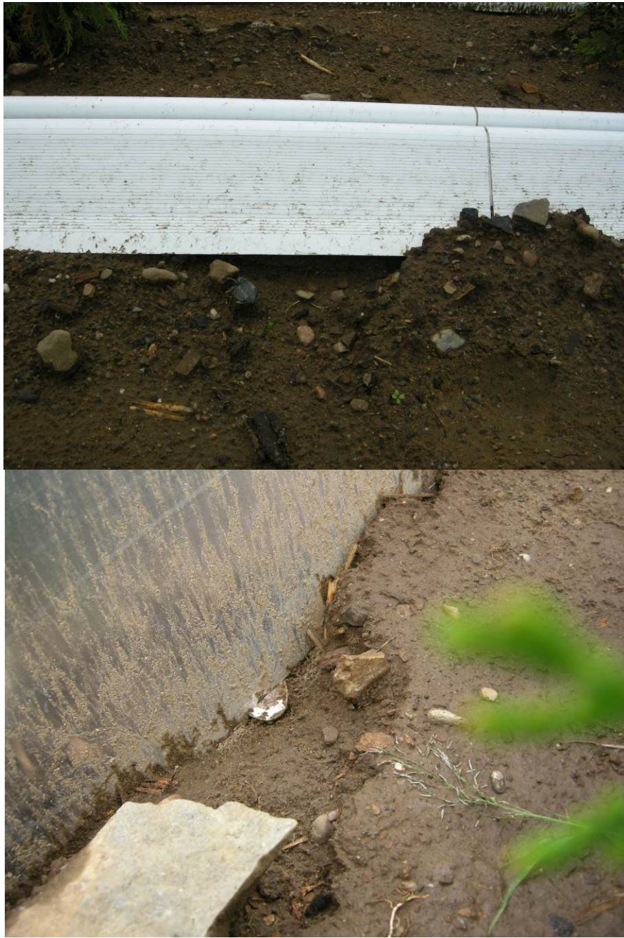
Figure 4 : Sections de barrière déterrée à la suite à de fortes précipitations
