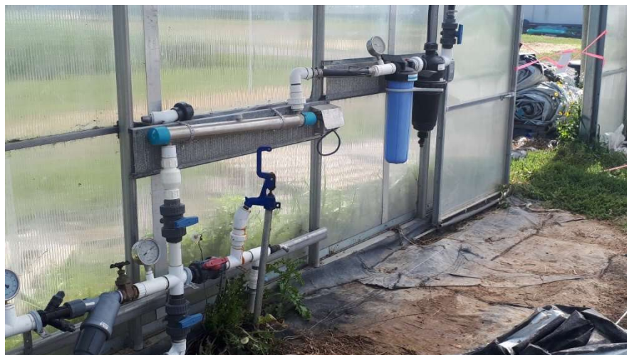
Photo 3 Système de traitement de l'eau par filtration et lampe UV
