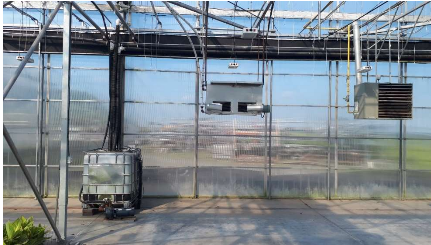
Photo 2 Réservoir de transfert situé dans une serre
