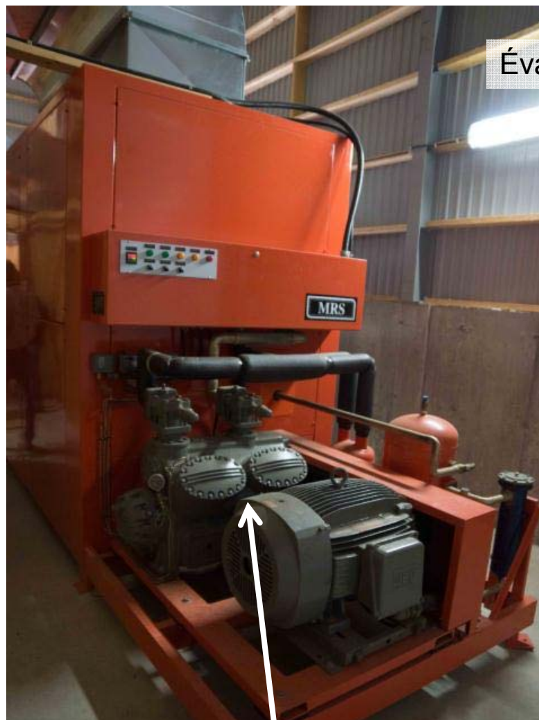
Compresseur Puissance nominale de 75 HP
