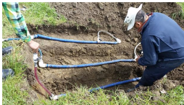
Figure 1: M. Garon installant le site de démonstration de la compaction à différentes profondeurs
